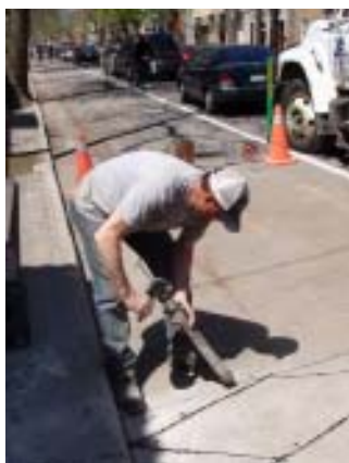
Installation d'un poste permanent de comptage de cyclistes à Montréal, au Québec.
